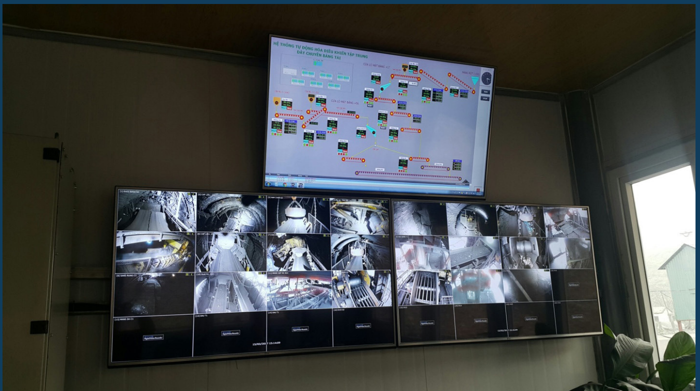
Toàn cảnh Hệ thống băng tải - Công ty than Mạo Khê.
